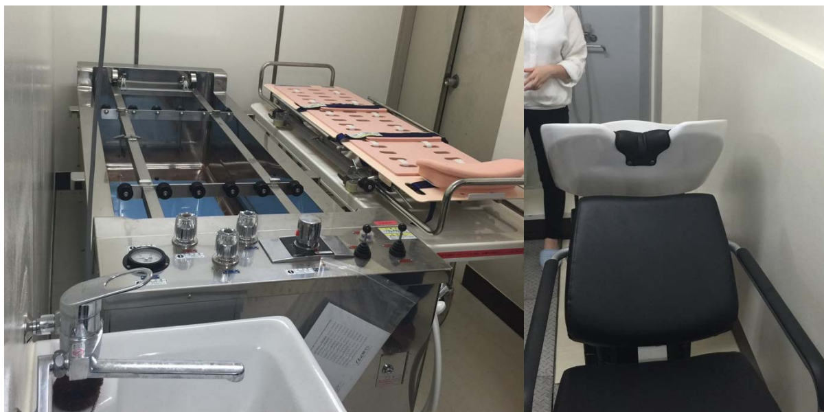
除汙設備：除汙櫃、坐式洗頭除汙設計。
