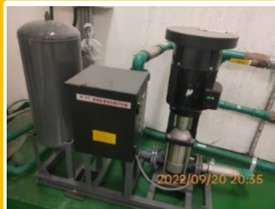
雨水回收過濾系統
