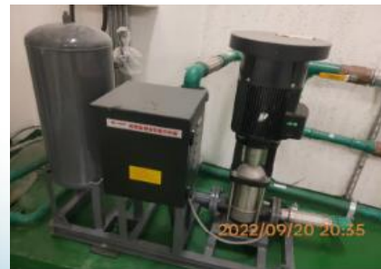
雨水回收過濾設備
