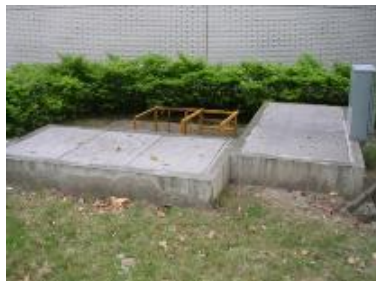
雨水回收系統緩衝過濾槽
