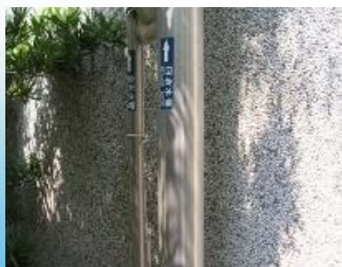
雨水回收系統水池管路
