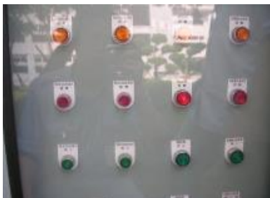
雨水回收系統控制盤
