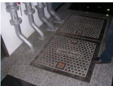
雨水回收系統收集槽
