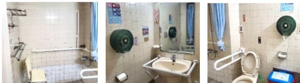
輪椅親善廁所 (無障礙洗手台、安全扶手及呼叫鈴)
